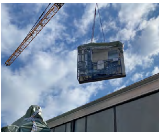
Höhere Planungssicherheit durch Vorfertigung: Unsere Module können just-in-time zur Baustelle geliefert werden. Bildquelle: Expocover
